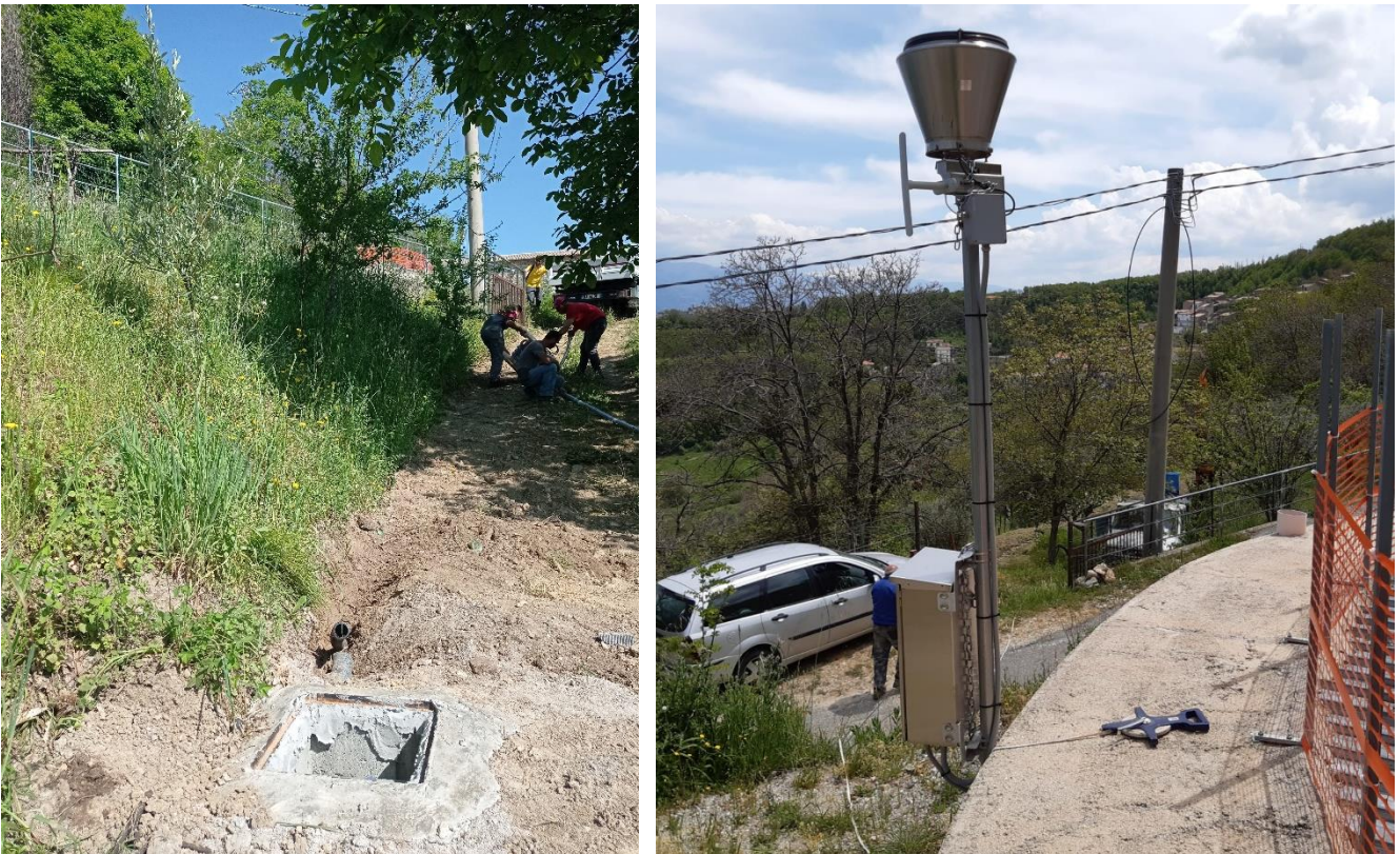
Figura 15: A sinistra il pozzetto da cui parte il corrugato, a destra il sito di alloggiamento della centralina.
