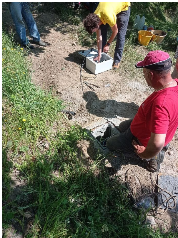
Figura 23: Test dei sensori in sede
