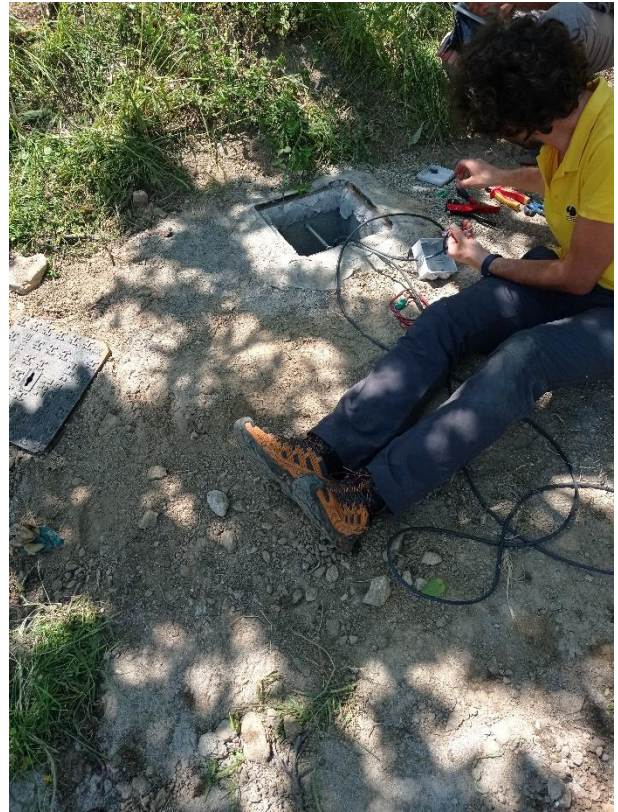
Figura 27: Cablaggio dei sensori alla centralina
