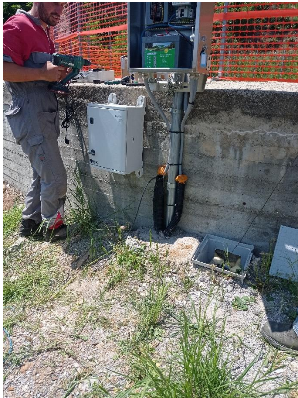
Figura 25: Installazione della centralina
