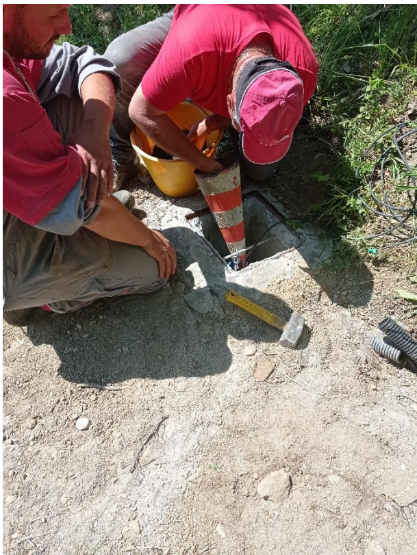
Figura 22: Inserimento di ghiaia per tutta la lunghezza del foro per stabilizzare i sensori
