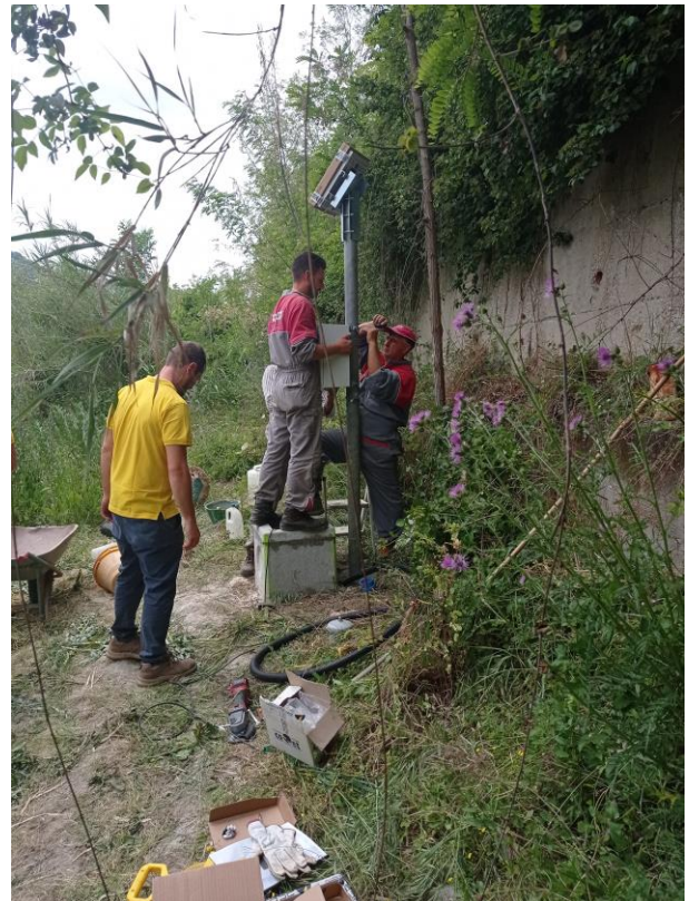
Figura 17: Installazione della centralina
