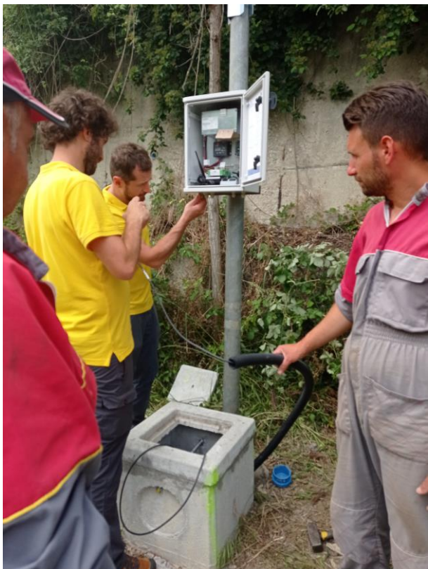
Figura 18: Cablaggio dei sensori alla centralina
