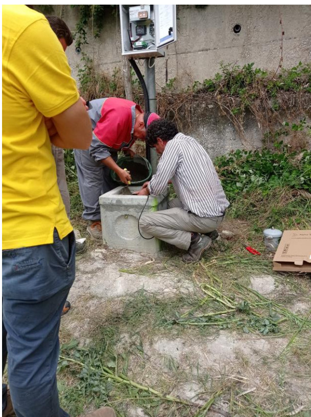
Figura 20: Inserimento nella parte alta del foro di malta cementizia per cementare l'ancora superiore
