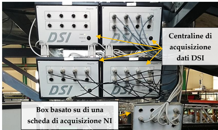
Figura 7: Centraline di acquisizione.
