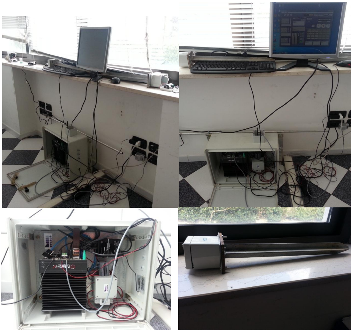
Figura 20. Esempio di sistema SWAN (alto sx) come installato presso il laboratorio STRAGO con una unità master (unità sull'armadio a terra, alto dx) e 4 unità SMAMID. Sul PC centrale sono attivi sia il software di controllo e gestione del sistema SWAN che il middleware di comunicazione verso il CAED. Ciascuna unità SMAMID è resa solidale a un supporto metallico (chiodo) da infiggere nel terreno (in basso a dx). Il PC industriale è accompagnato da un modem (dettaglio in basso a sx) tramite cui avviene la trasmissione dati.
