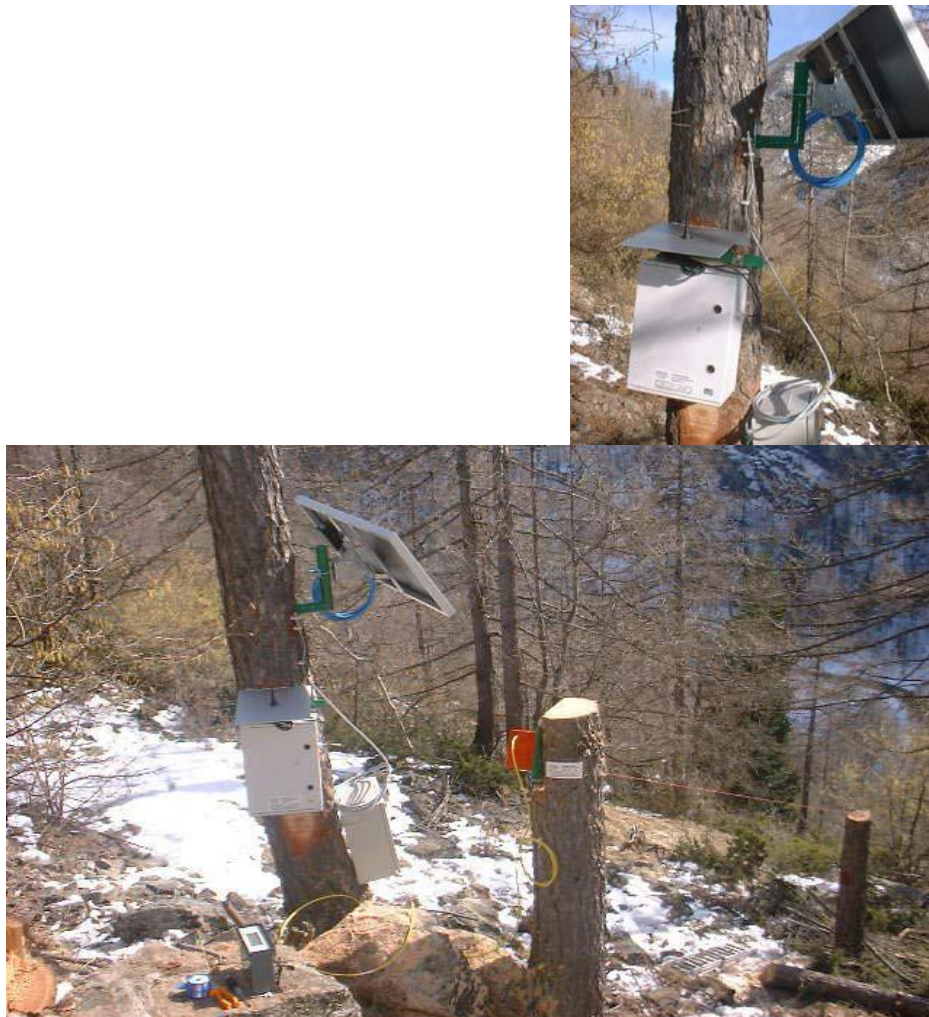
Figura 39,40. Centralina di acquisizione dati ed estensimetro a filo posto a cavallo della fessura da rilevare
