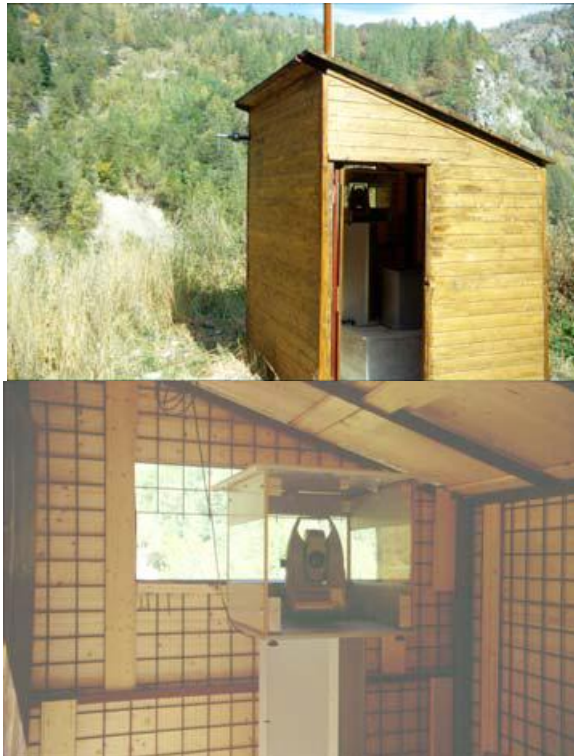
Figura 36. Alloggiamento della stazione totale robotizzata
