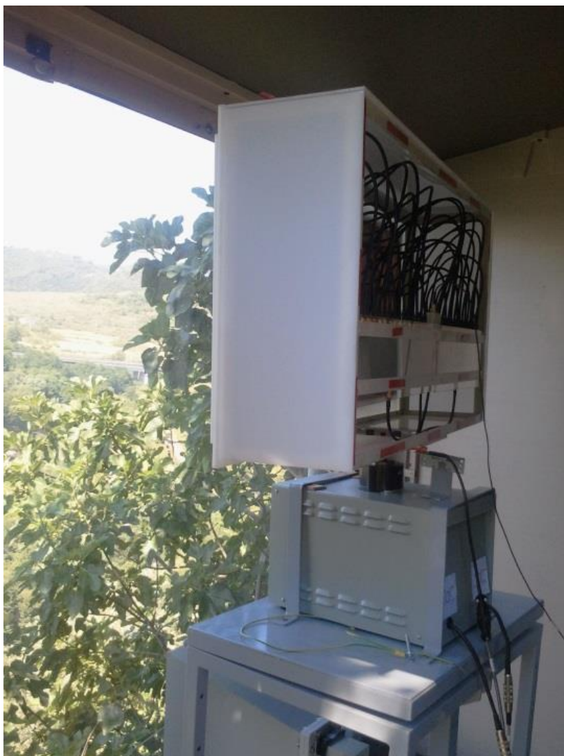
A3, UGM 1 - Sistema SDRadar montato all'interno della struttura di protezione
