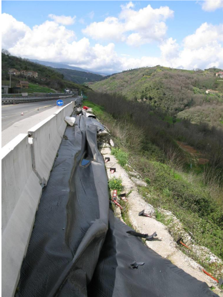
A3, UGM 1 - Frana Mancarelli in corrispondenza del rilevato autostradale
