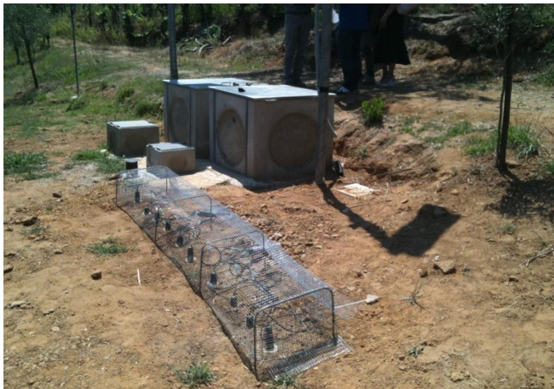
A3, UGM2: tensiometri in opera e pozzetti di alloggiamento piezometri, inclinometri e scatole di derivazione
