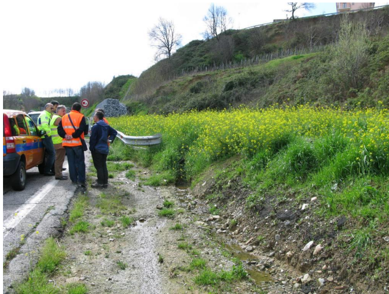
A3, UGM 2 – frana Fiego: fronte in corrispondenza della carreggiata
