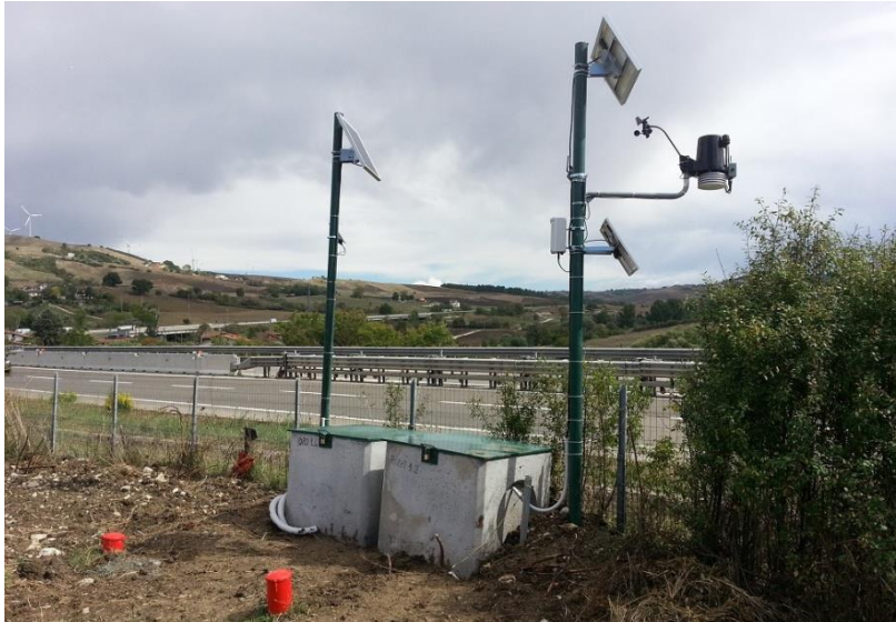
A16, km 97+450: Sistema per la misura degli spostamenti nel terreno in profondità e delle pressioni neutre (perforazioni)
